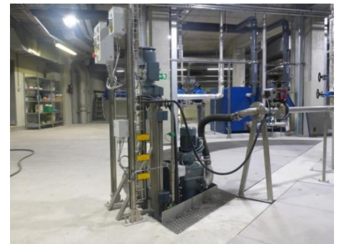
Schwimmstoffabzug aus Fettfängen
