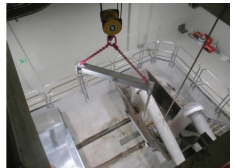
Abwasserrechen mit Rechengutwaschpressen und Rechengutmulden
