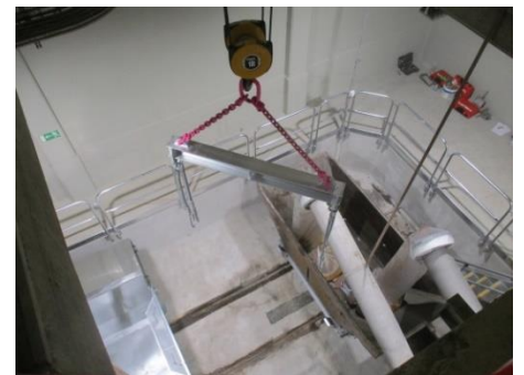
Abwasserrechen mit Rechengutwaschpressen und Rechengutmulden
