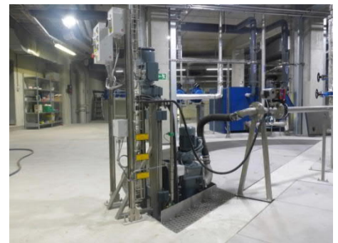
Schwimmstoffabzug aus Fettfängen
