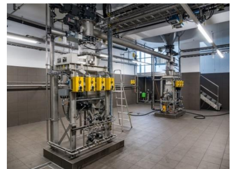
Anlage zur Dosierung vom PAK und Herstellung einer PAK-Wasser-Suspension
