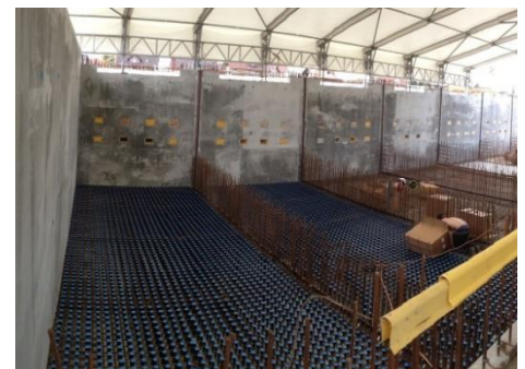
Erstellung Düsenboden Filtration
