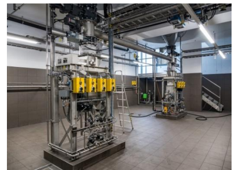
Installation pour le dosage du CAP et production de la suspensions eau-CAP
