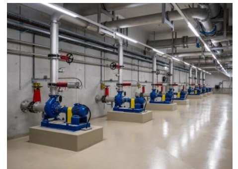
Pompes de recirculation des boues CAP
