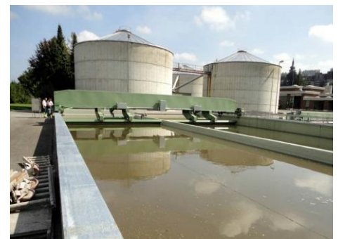
Vorklärung und Tropfkörperanlage
