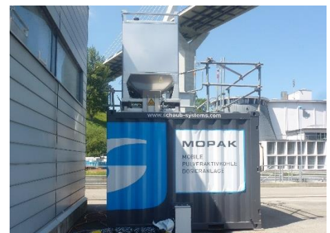
Installation mobile de dosage du CAP (Schaub)
