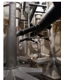
Innenansicht des Filters vor der Befüllung
