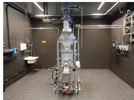
Station de dosage du charbon actif en poudre
