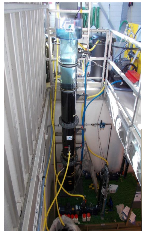
Installation pilote du CarboPlus®
