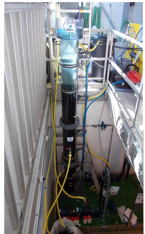
Installation pilote du CarboPlus®
