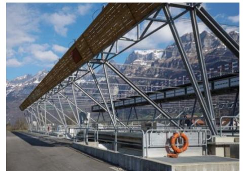
PV-Anlage über dem Klärbecken
