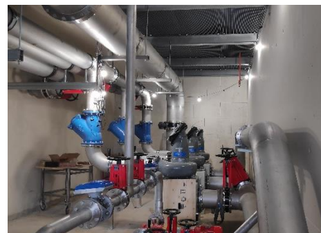
Chambre des pompes
